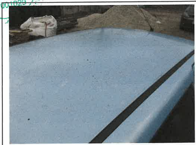
Fot.18. Uszkodzony dach
