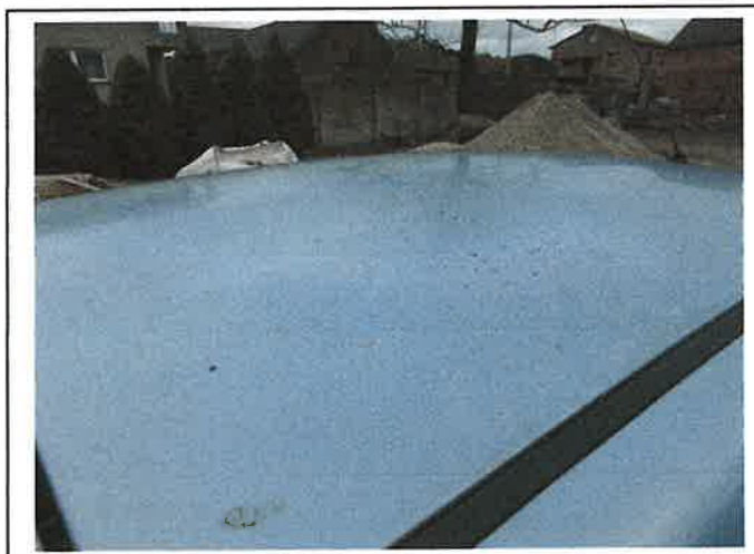
Fot.19. Uszkodzony dach
